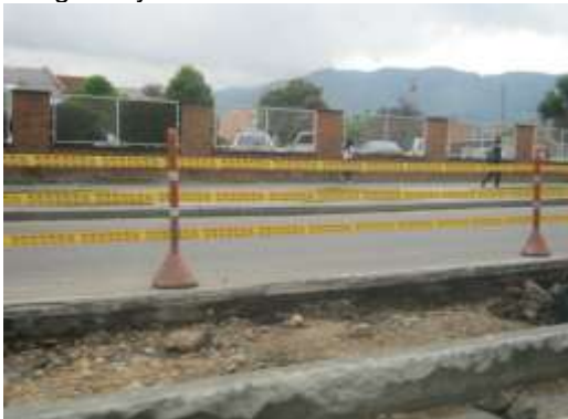
Imagen 1 y 2. Pendiente intervención en separador
